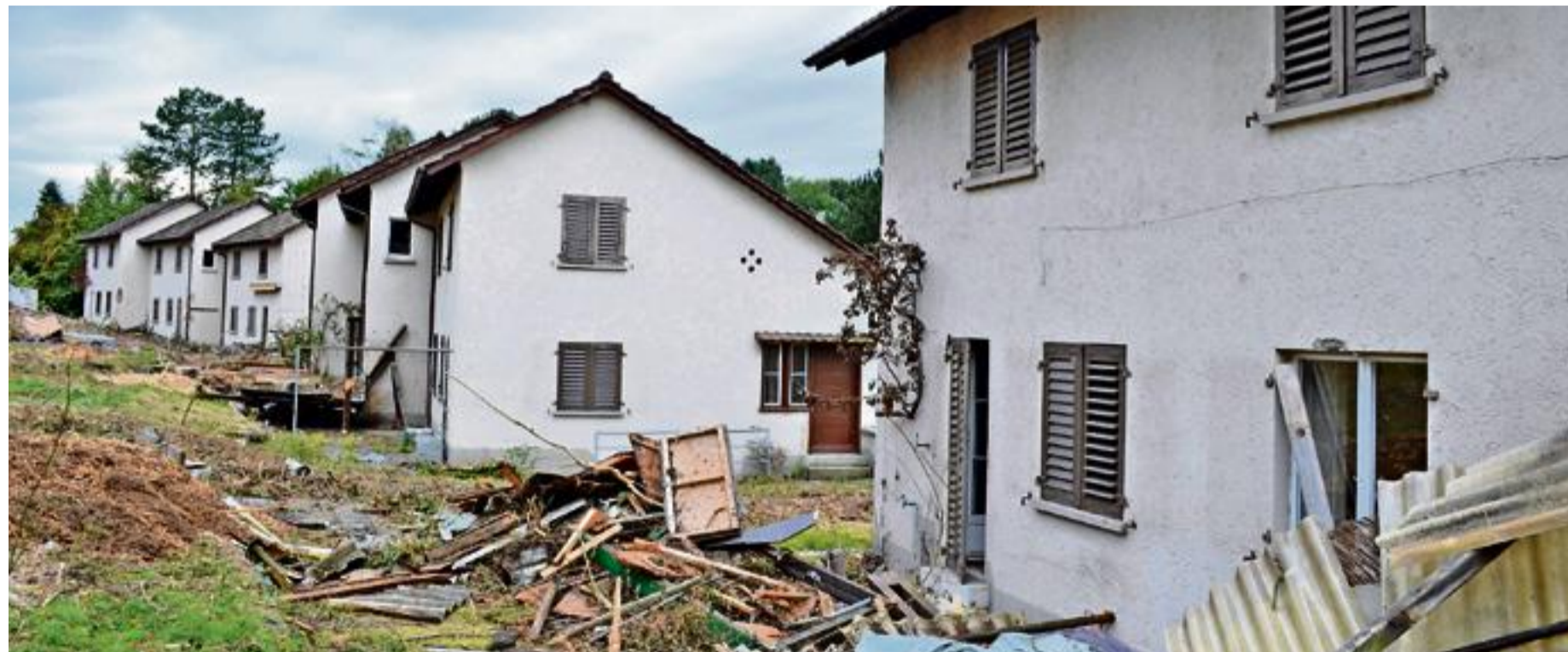
Beinahe 70 Jahre lang stand in der Au in Meilen eine Reihe Einfamilienhäuser. Sie wurden gebaut als Firmenwohnungen für Mitarbeitende der Produktion AG Meilen (heute Midor AG). Jetzt wird die Siedlung abgebrochen und macht zwei Mehrfamilienhäusern Platz. Urs Köhle
